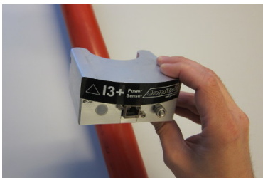
图 6: 将传感器放置在待测的电缆线上。
